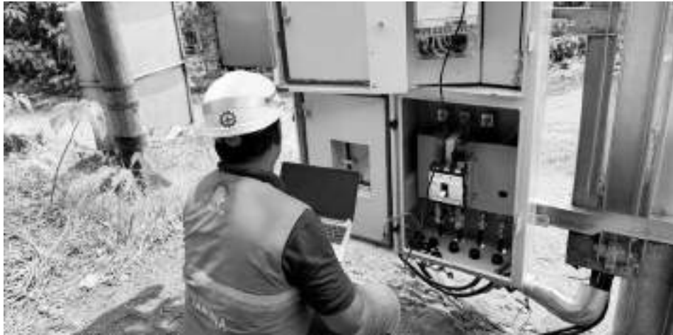
TEKNISI PLN sedang melakukan pengecekan gardu panel listrik setelah PT PLN (Persero) Unit Layanan Pelanggan (ULP) Siau resmi melakukan penyambungan listrik baru berdaya 82.500 VA untuk mendukung operasional PT Gading Murni Perkasa 2. FOTO: DOK.PLN
