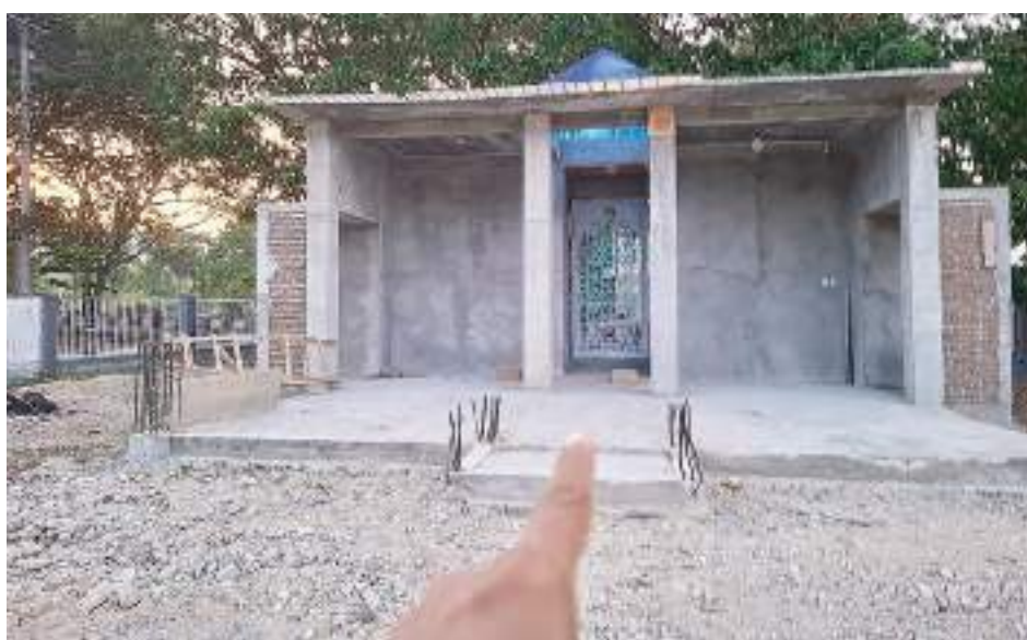
PROYEK pembangunan musala di kantor Inspektorat Parigi Moutong yang sedang diselidiki oleh Kejari Parigi Moutong. FOTO: ASLAN LAEHO
