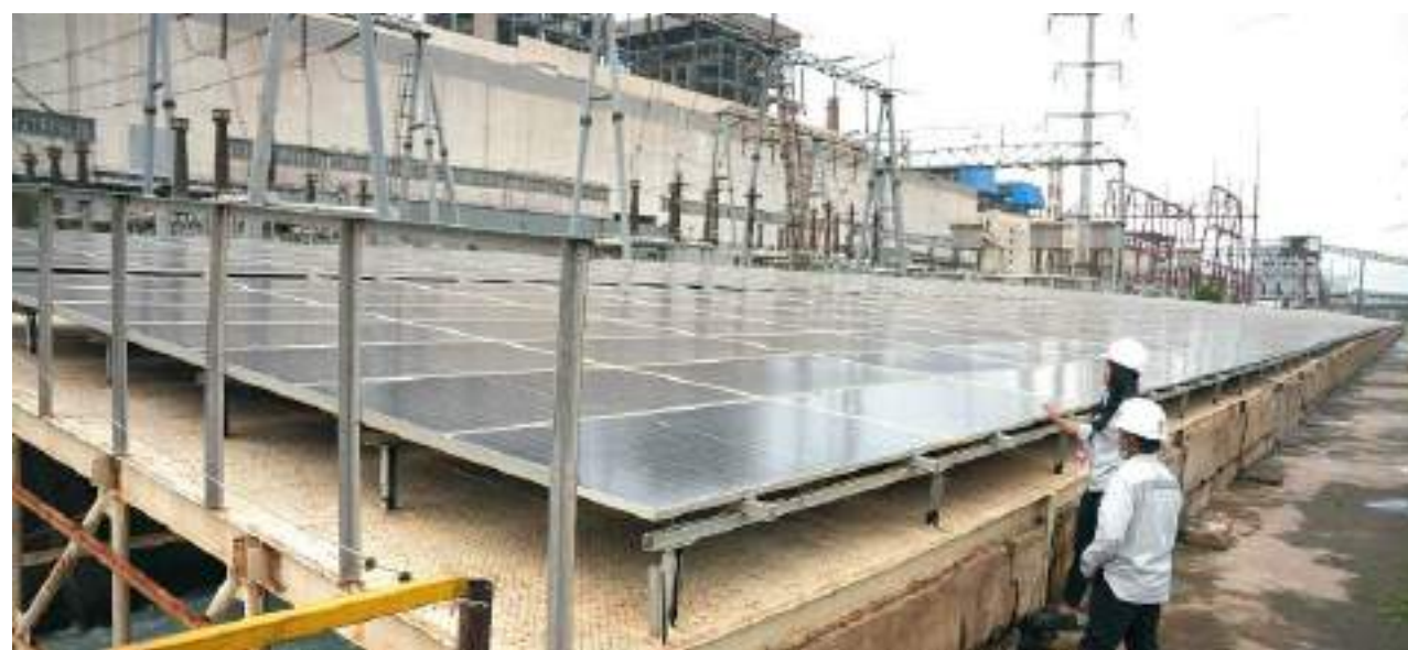
PANEL surya di atas jalur kanal Fatufia di kawasan PT IMIP. FOTO: IST
